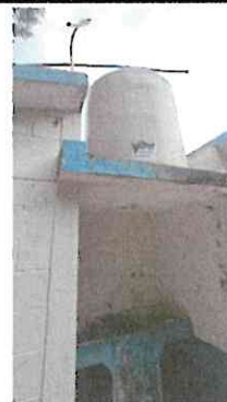
Foto 2: los tinacos se llenan manualmente y se le saca el agua con manguera porque no funcionan
