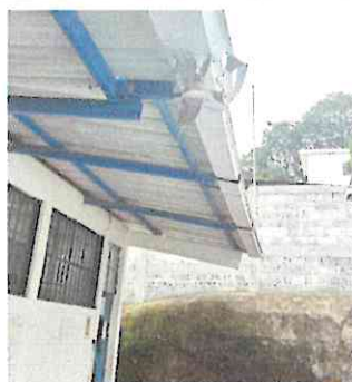
Foto 3: canales en mal estado
