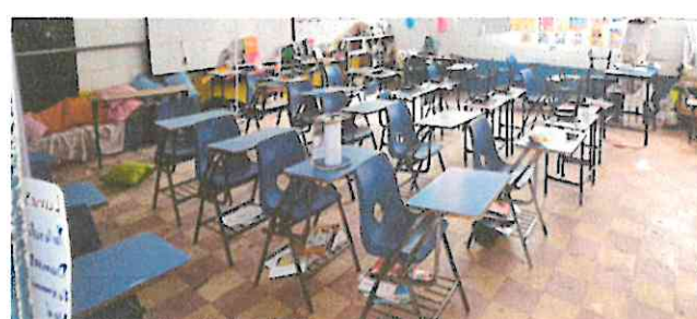
Foto 2: Piso viejo, a desnivel se reposa el agua
