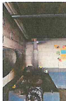
Foto 4: La chimenea no sirve, no es funcional se ahuma la cocina
