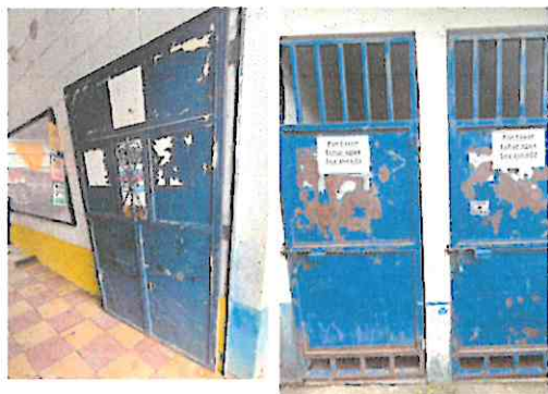
Foto 1: Puertas deterioradas y en mal estado por el paso del tiempo
