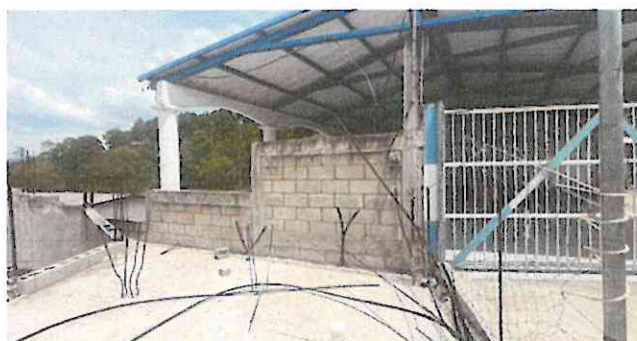
Foto 3: La escuela no es segura porque el tapial está muy bajo
