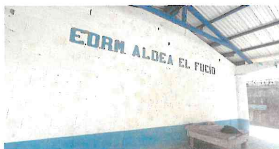
Foto 4: las instalaciones se encuentran manchadas y pintura en mal estado
