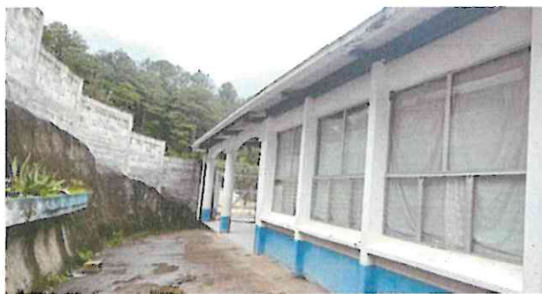
Foto 6: las ventanas no cuentan con balcones, vulnerando las seguridad de las aulas y dirección
