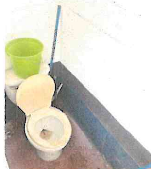
Foto 5: baños en mal estado y no funcionales para con su sistema de drenaje
